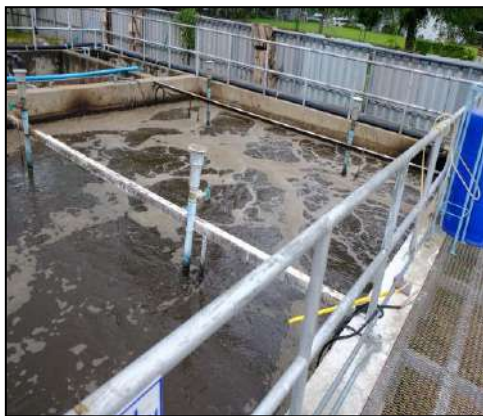
บ่อเติมอากาศ
