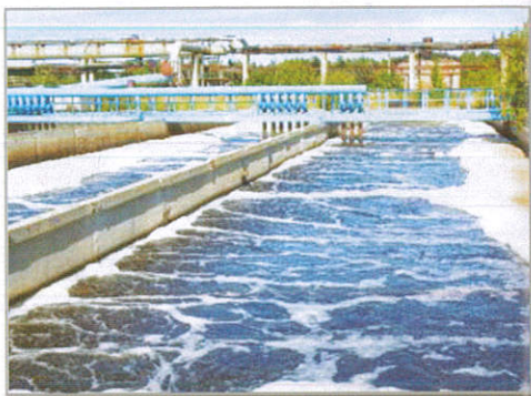
บ่อบำบัดน้ำเสีย
