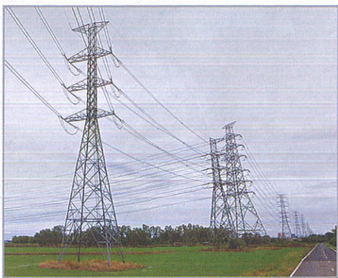
เสาไฟฟ้า
